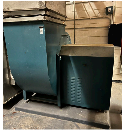
Existing Return Air Fan (RF-1)
