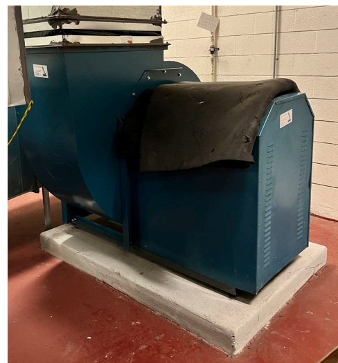
Existing Return Air Fan (RF-5)
