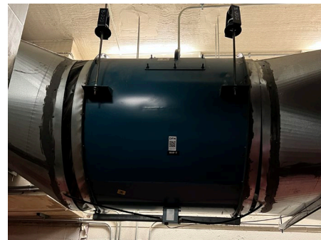
Existing Return Air Fan (RF-7)
