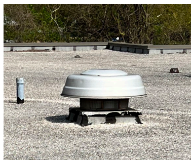
Existing Exhaust Fan
