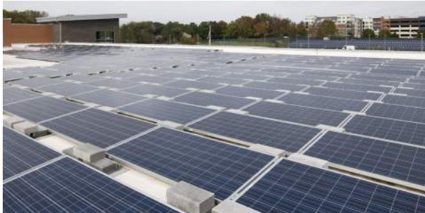
660Kw Solar Array
